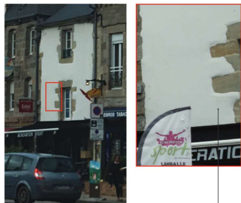
Un enduit trop épais sur la façade dépasse les pierres de chaînages et les encadrements 8 rue de Loumel (sur la place du marché)
