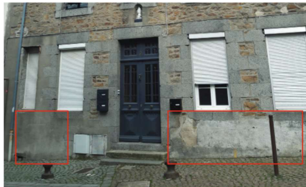
Reprise en ciment et altérations de la pierre en soubassement
