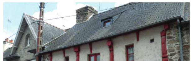
Perçement de châssis dans la toiture, 46 rue Paul Langevin
