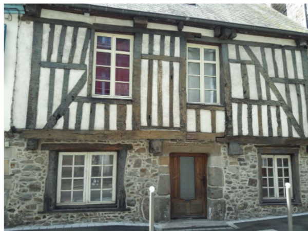
Maison en pans de bois avec soubassement en pierre et moellons, rue Saint-Lazare
