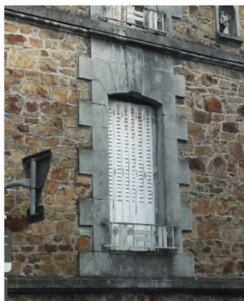
Détails en ciment Maison Bourgeoise, XVIIIe 1, 3 rue de la Croix au lait
